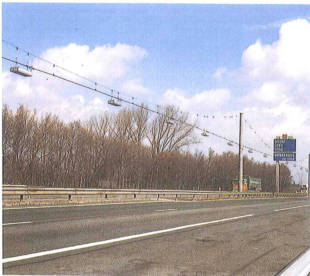
Photo 6. — Installation caténaire expérimentée en 1985 près d'Arras dans une zone exposée à des brouillards fréquents.
