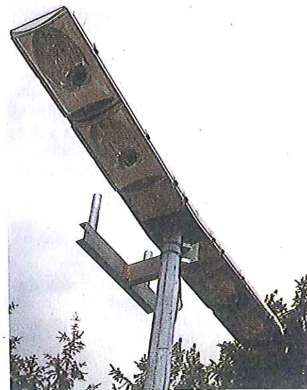
Photo 4. — Luminaire et ses 4 optiques situées à l'extrémité du mât ici prévue pour recevoir les projecteurs d'appoint destinés aux zones sans terre-plein central lorsque l'espacement dépasse 80 m.
