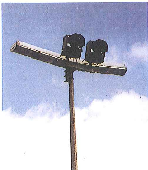
Photo 5. — Projecteurs d'appoint qui équiperont les mâts situés à l'extrémité des zones sans terre-plein central. Chaque projecteur est muni d'un système de défilement pour réduire l'éblouissement des usagers.
